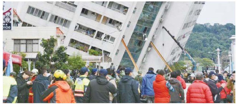
花蓮災情最嚴重的雲翠大樓震後傾斜30度
